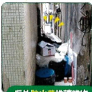
戶外防火巷堆積雜物
